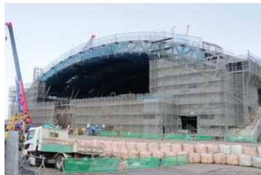
来年10月に開業予定の屋内総合スポーツ施設「サオリーナ」=津市北河路町で
